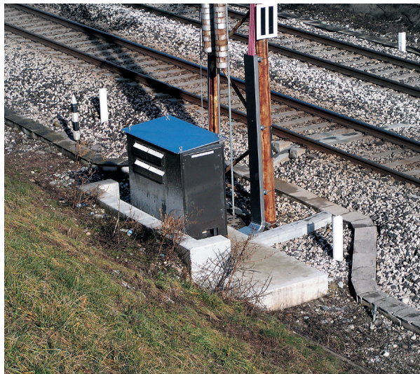
Sezionatore unipolare o bipolare di messa a terra in esecuzione estraibile a bordo quadro per esterno o per installazione in galleria
